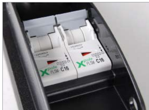
Protección adecuada de los disyuntores o enchufes con fusible individuales.
